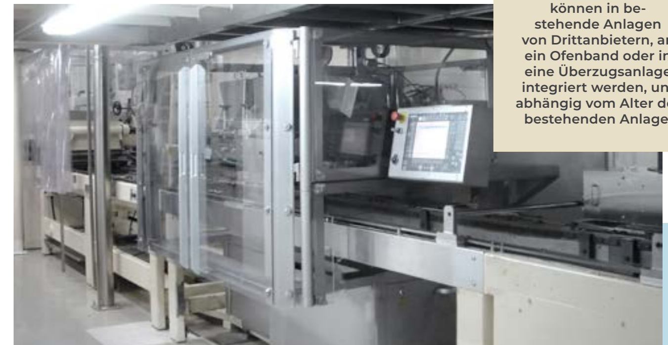
Die Alpha wurde erfolgreich in eine alte Anlage integriert.
